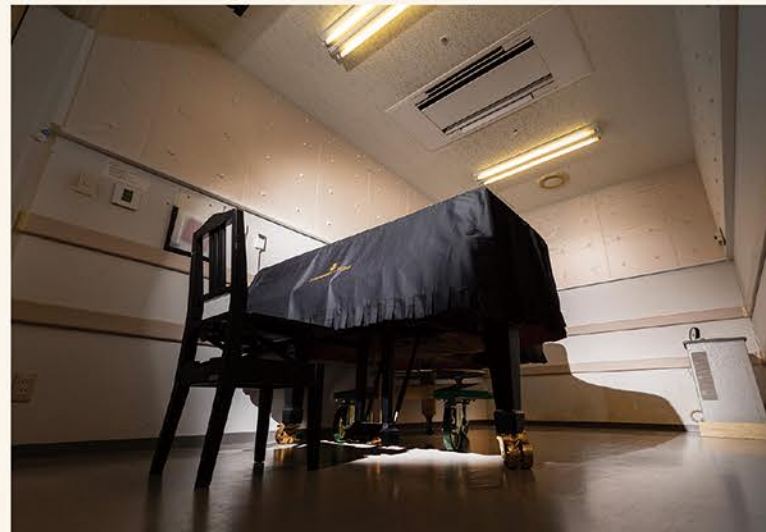
*知られざるピアノの寝床と金子さんが表現したピアノ庫。ハーモニーホールふくいは大ホール、小ホールそれぞれの舞台裏にピアノ庫があり、24時間365日、絶え間なく温湿度調整が行われています (写真は小ホール)。
